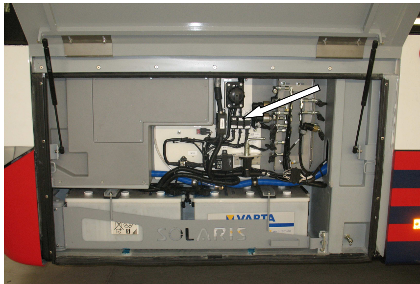
Rys. 15.4. Płyta elektryczna w komorze akumulatorów – wskazana strzałką
